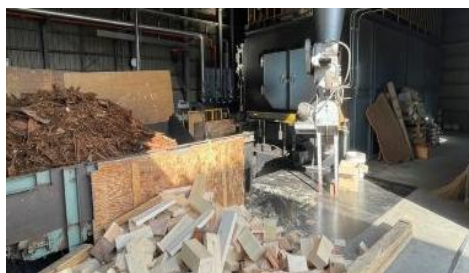
写真 2-11 木質バイオマスボイラー
