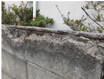
割れや鉄筋の露出がみられる塀
