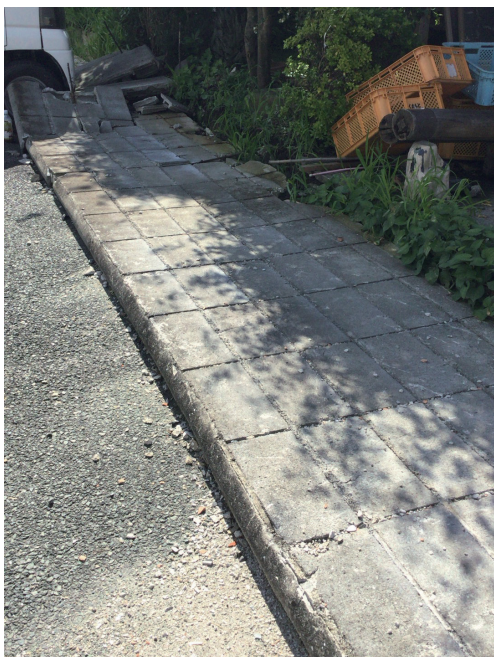
地震によりブロック塀が倒壊
