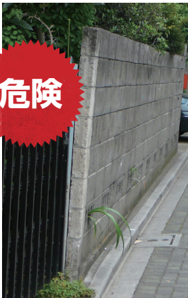
傾いている危ない塀
