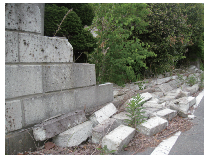
地震により石塀が倒壊
