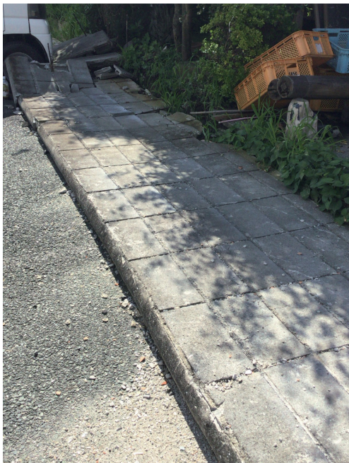
地震によりブロック塀が倒壊
