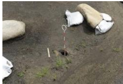
第 63 図 H30 年の陥没（西側）発見状況
