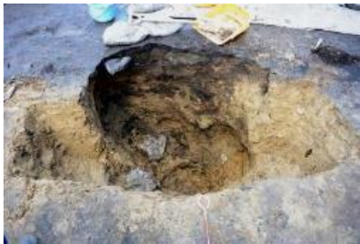
第 62 図 H24 年の陥没調査状況
