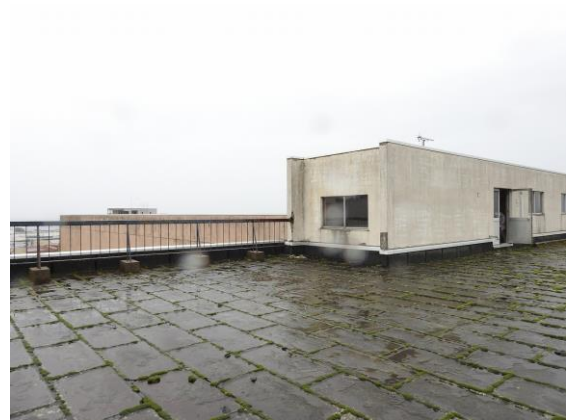
屋上防水の劣化 (劣化度D)
