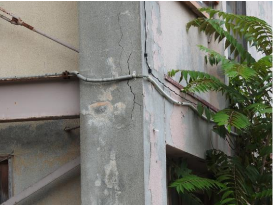
クラック (劣化度D)
