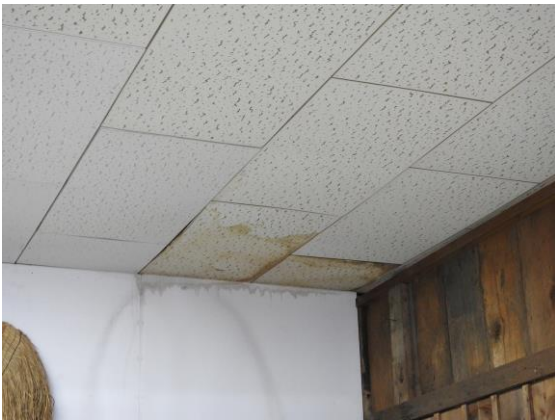
漏水跡 (劣化度D)
