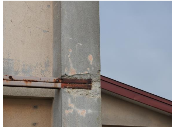
鉄骨の露出 (劣化度D)
